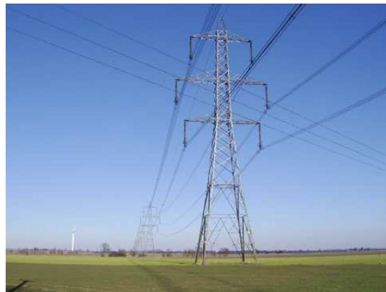
Massiewe kragpale steun die transmissielyste regoor die land.
